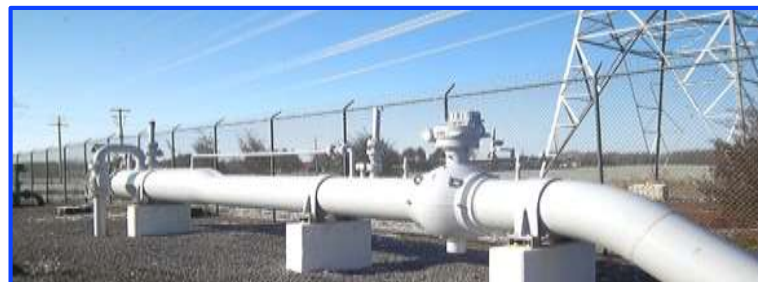
Энергоснабжение газопровода – линии электропередачи
