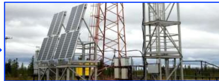
Энергоснабжение газопровода – солнечные батареи
